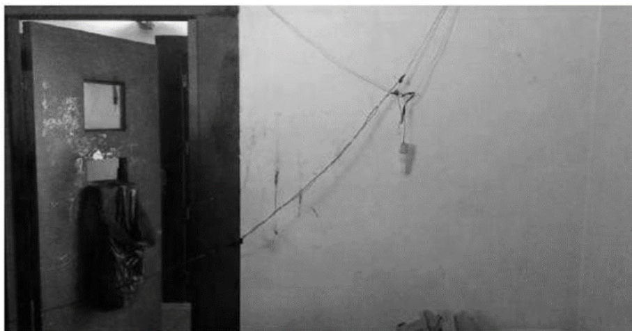
Figura 4 - Portas riscadas e fiação exposta na nova Unidade de Internação de São Sebastião/DF
