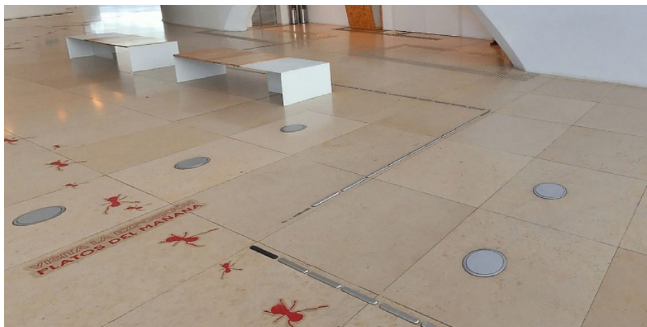
Figura 1 - piso tátil danificado
